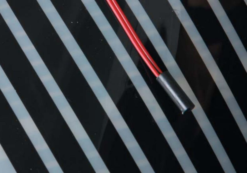
Рис. 21. Установка датчика температуры пола SF 4x15
